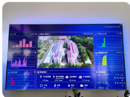
電力監控系統資訊看板
